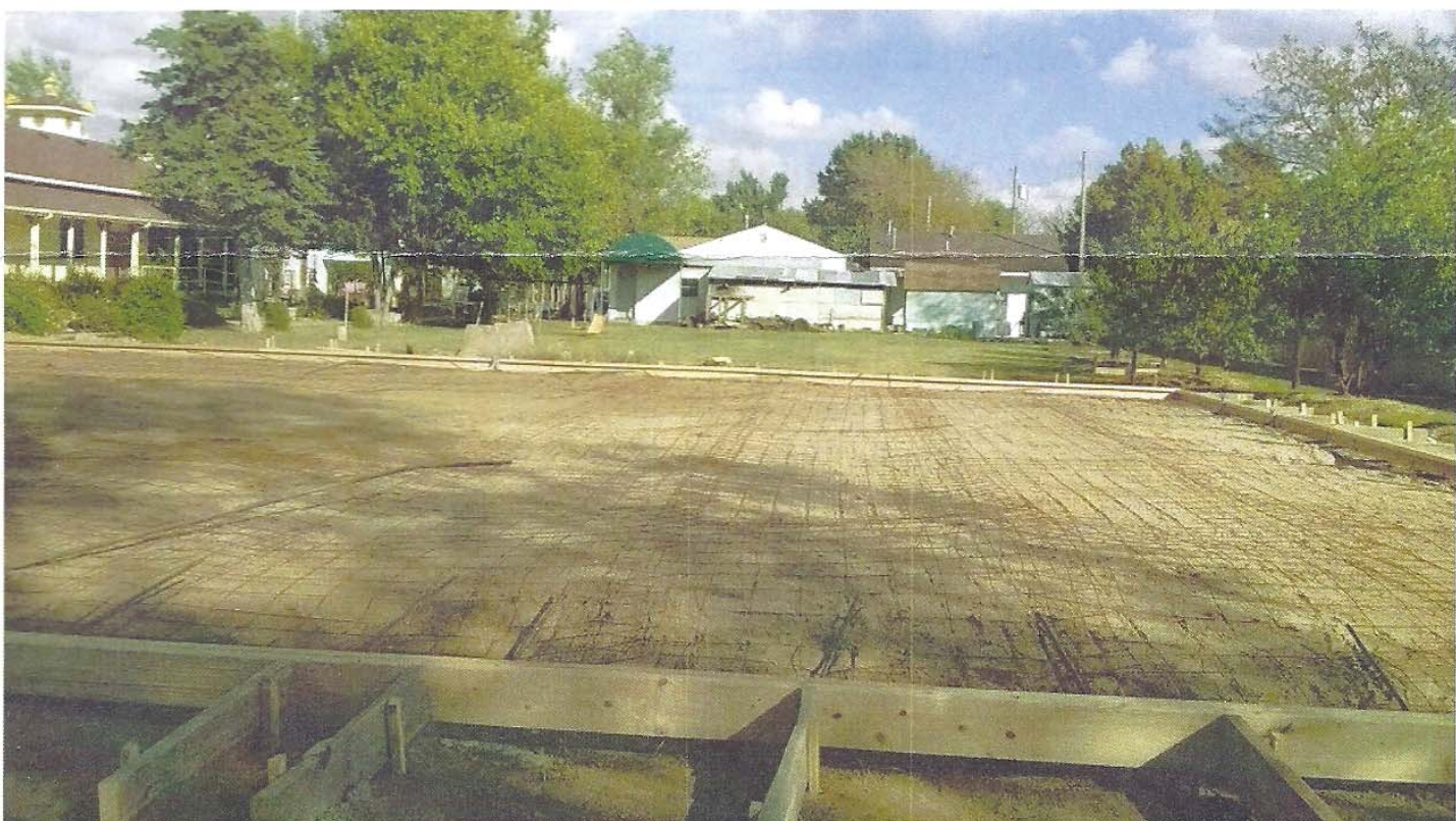
Nền móng Hội trường chuẩn bị đổ bê tông 120 Feet dài, 40 feet rộng
